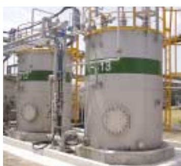
曝気槽(高岡工場)
