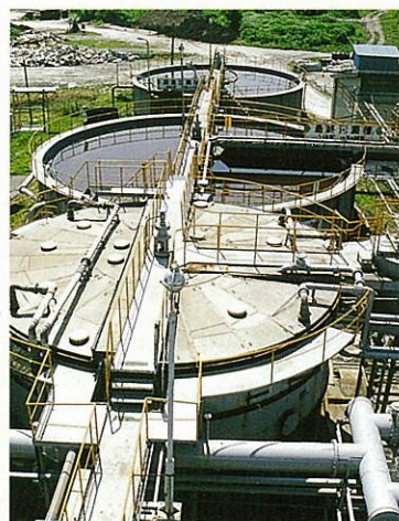
二本木工場 活性汚泥施設
