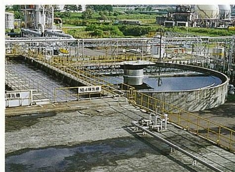
高岡工場 活性汚泥施設
