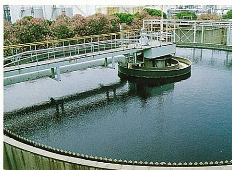
千葉工場 排水処理沈殿槽
